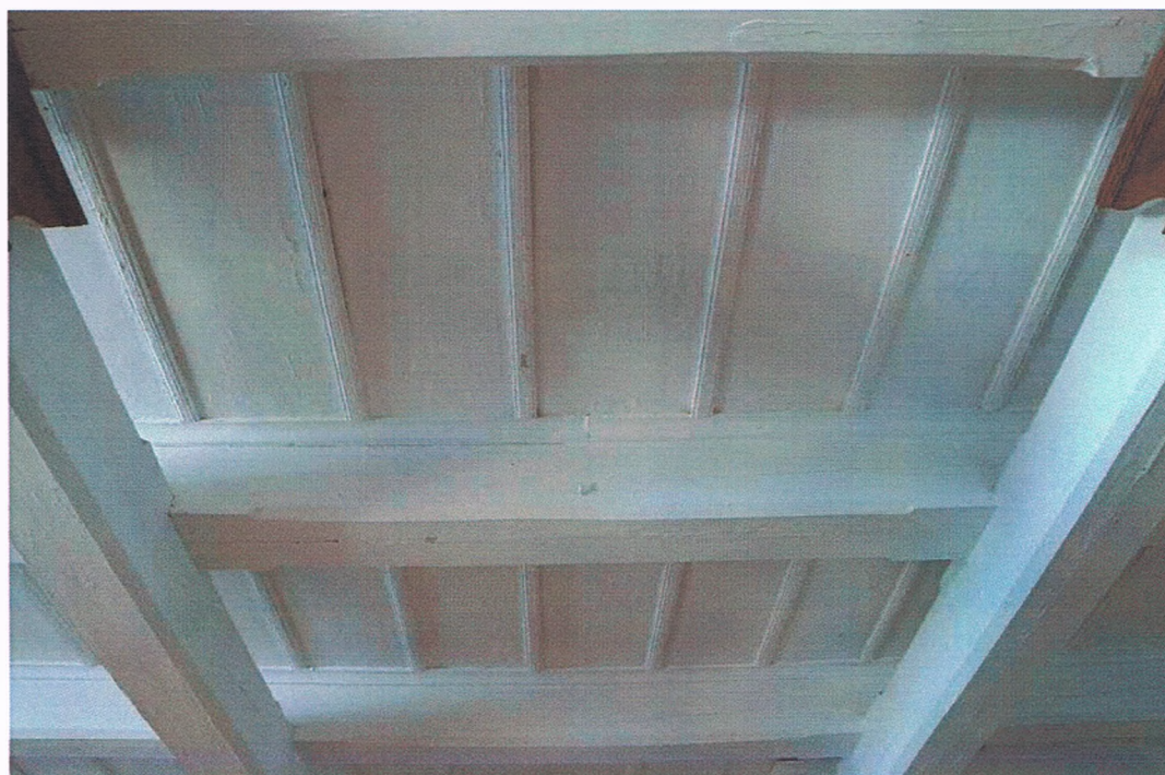
Fot. 22. Deskowanie empory w kościele filialnym pw. św. Jana Chrzciciela w Mysłowie.
